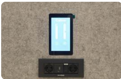
Beleuchtung und Belüftung
